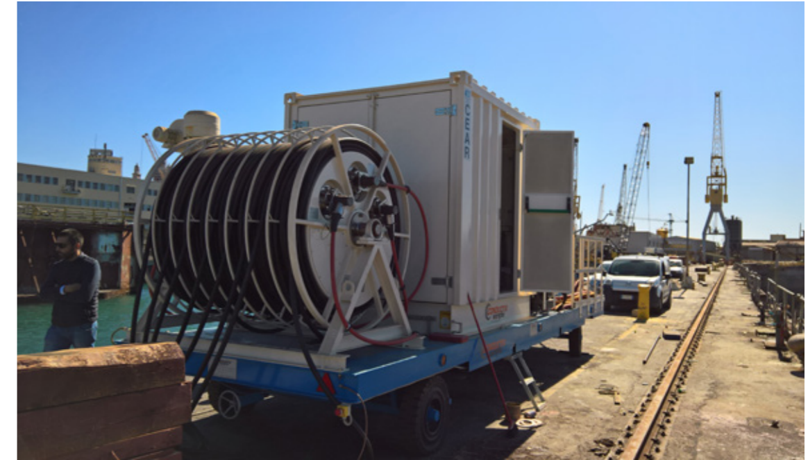
Fig.17A Struttura mobile per l'alimentazione delle navi
