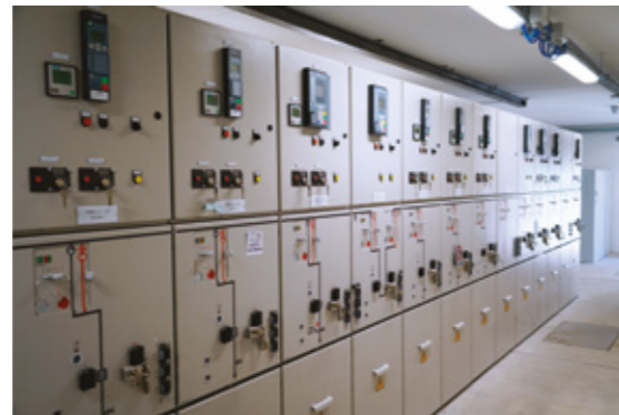
b) Quadro GIS a 20 kV
