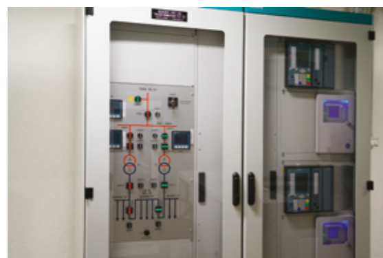
c) Armadio protezione e controllo 132 kV
